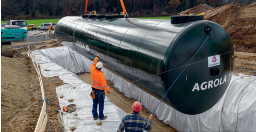
120 000 Liter umfasst der Treibstofftank, der auf der Baustelle der Agrola Tankstelle in Sumiswald versenkt wurde. Bild: zVg
