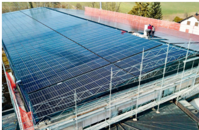
A Echallens, l'installation photovoltaïque produit notamment le courant utilisé par la station de recharge électrique rapide.
