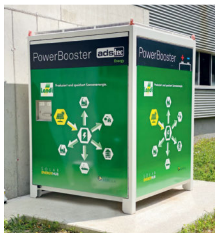
Les charges sont réparties uniformément grâce à la batterie de stockage. Photo : AGROLA
